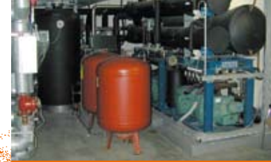
Abb. Wärmepumpe im IWG
